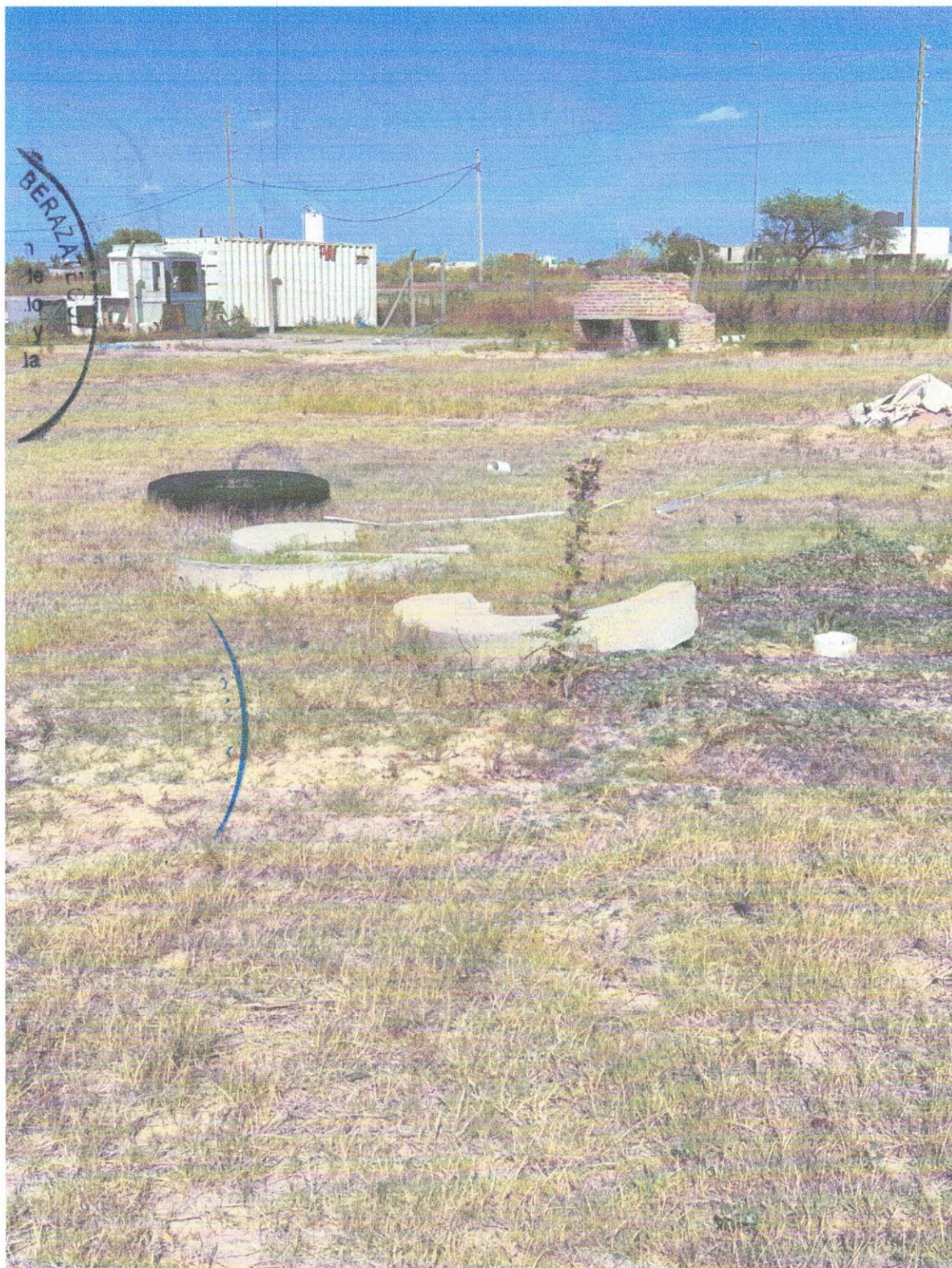
Figura 5. Tuberías/ caños rotos.
